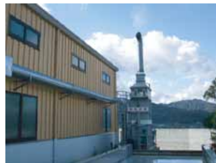
工場排気をスクラバー脱臭装置へ
